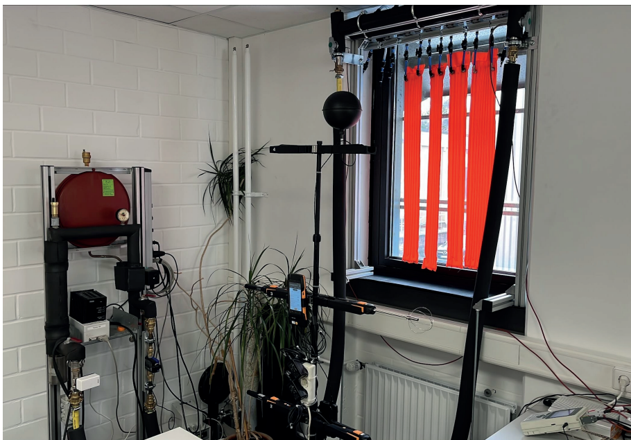
Bild 5: Demonstrator in realem Büroraum
