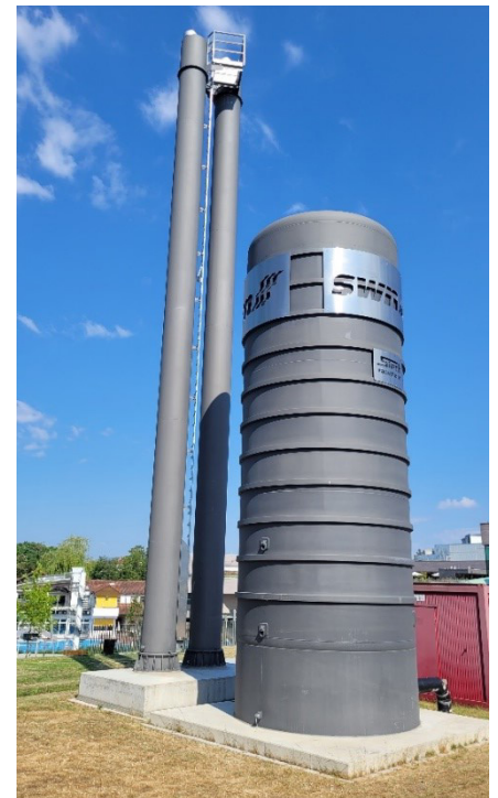
Bild 2: Warmwasserspeicher mit Vakuumwärmedämmung außen aufgestellt auf der Liegewiese des Schlossbads in Neumarkt i. d. Oberpfalz
